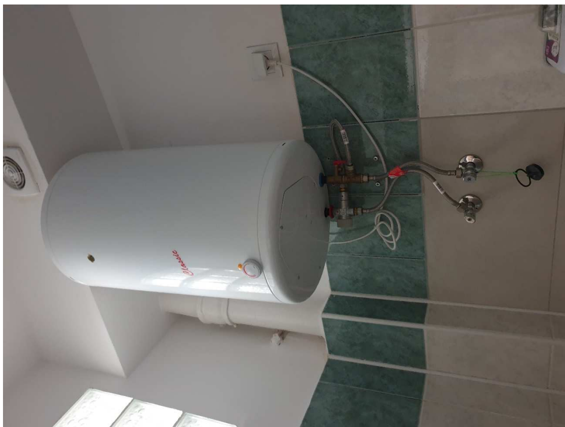
Fot. 17 WC na piętrze – podgrzewacz do ciepłej wody użytkowej
