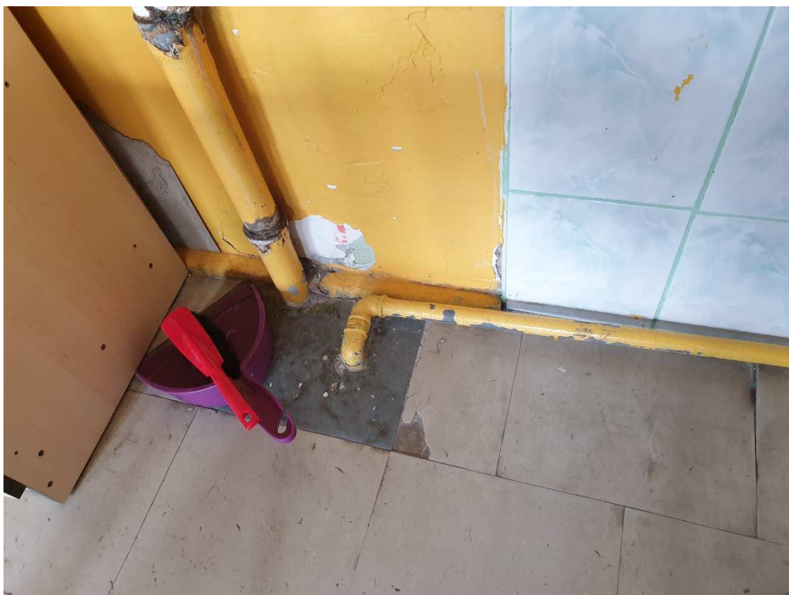
Fot. 12 Sala lekcyjna – instalacja sanitarna
