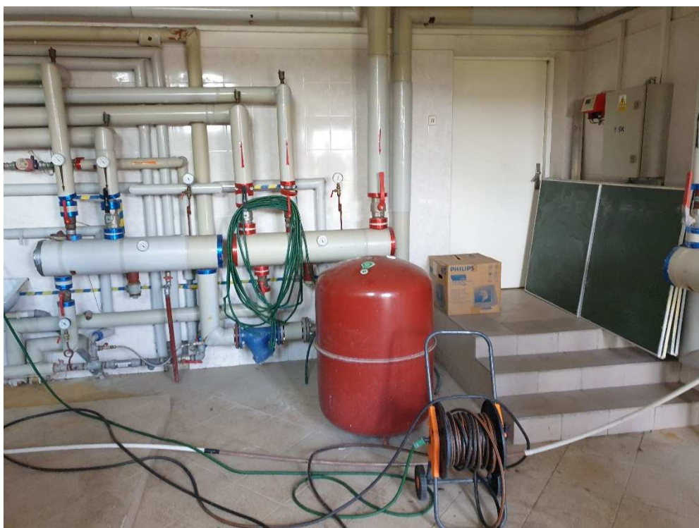
Zdj. 4 Pomieszczenie kotłowni.
