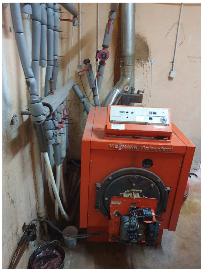
Zdj. 5 Kocioł olejowy w kotłowni.
