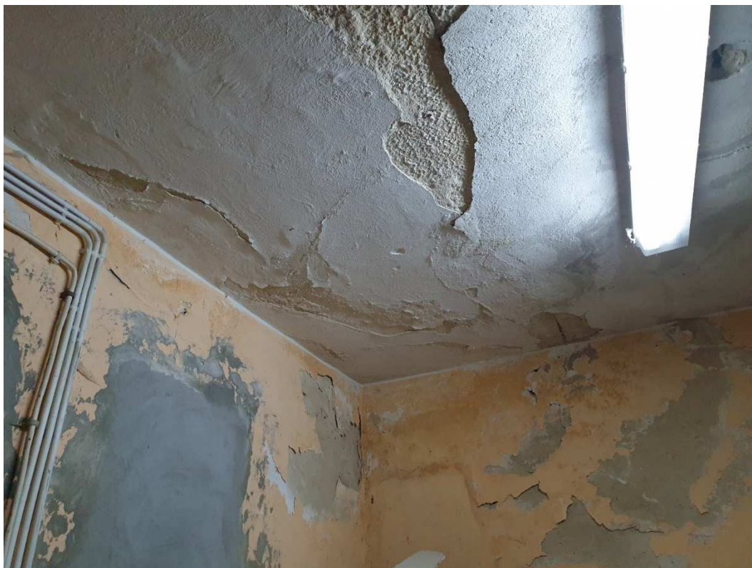
Zdj. 6 Stan techniczny kotłowni.
