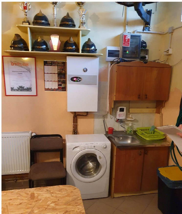
Zdj. 2 Kocioł elektryczny w pomieszczeniu remizy.
