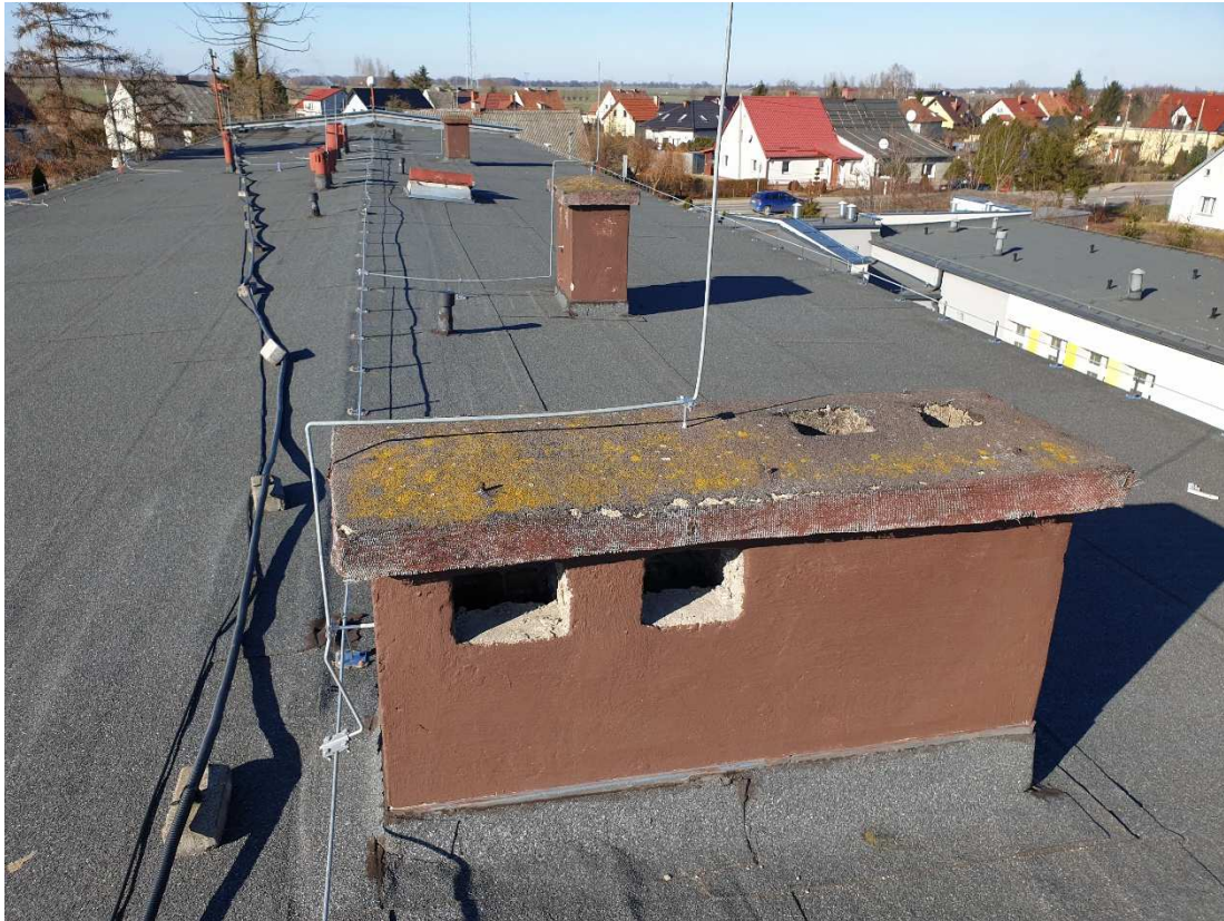
Zdj. 1 Stan techniczny stropodachu części głównej.
