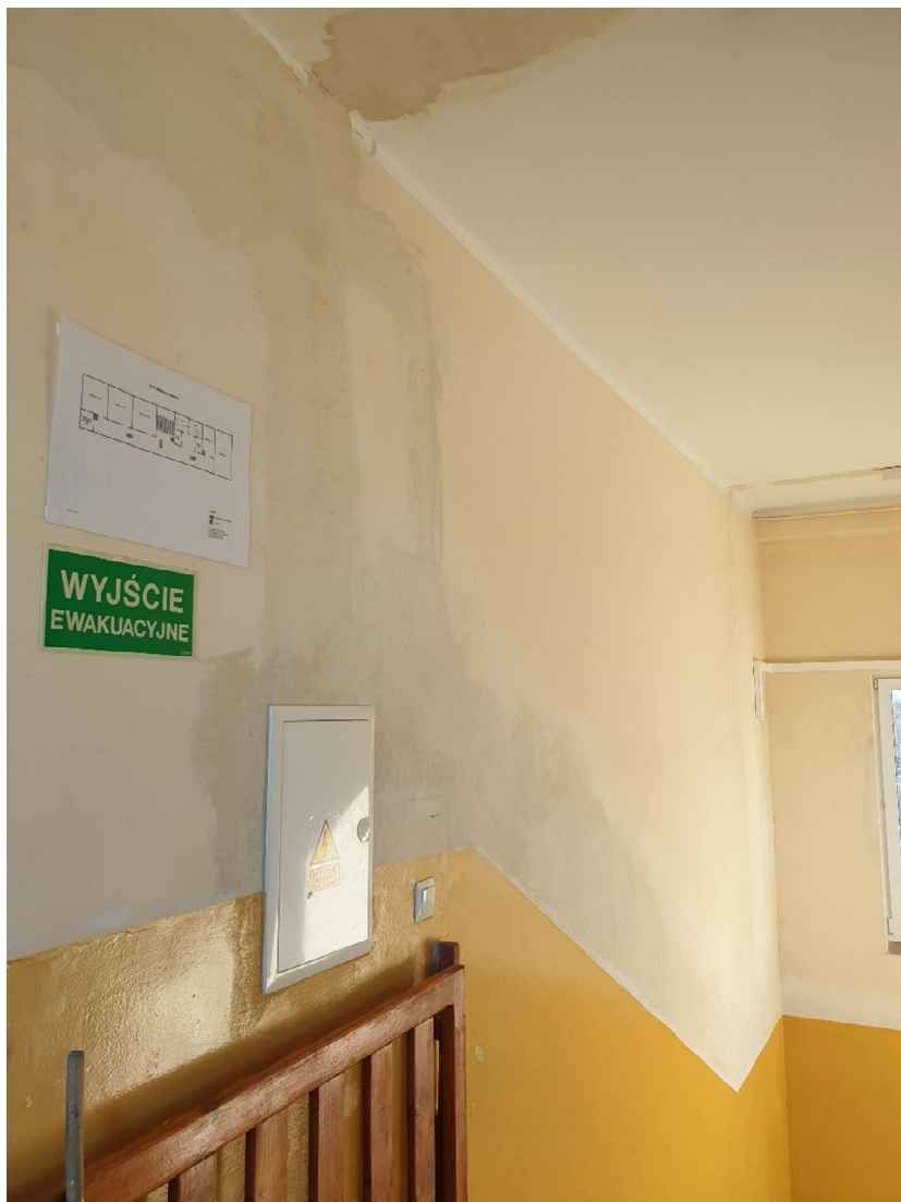
Zdj. 4 Stan techniczny wnętrza szkoły.
