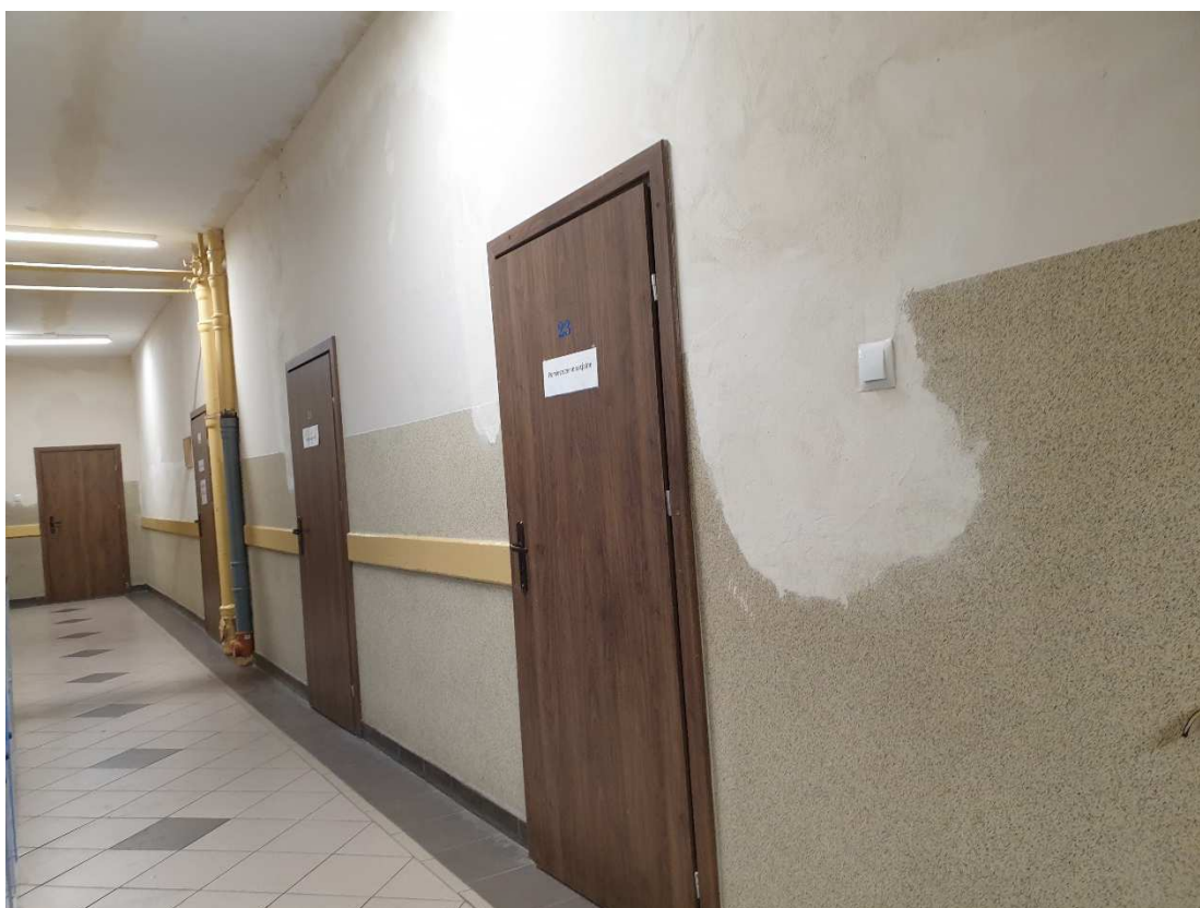
Zdj. 3 Stan techniczny wnętrza szkoły.
