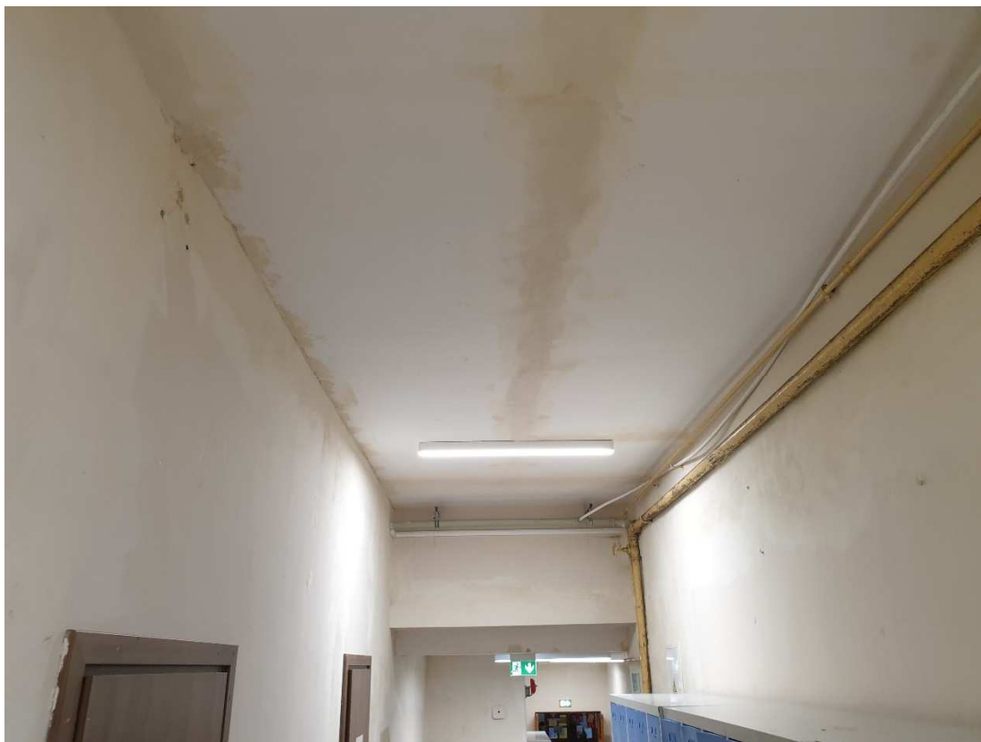
Zdj. 2 Stan techniczny wnętrza szkoły.
